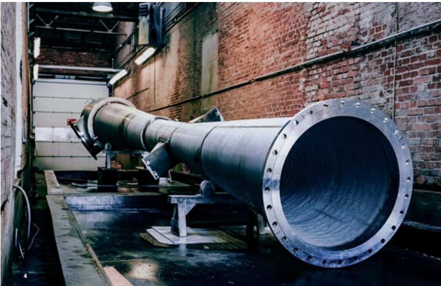
Dampfstrahlverdichter in den Fertigungshallen in Hannover
