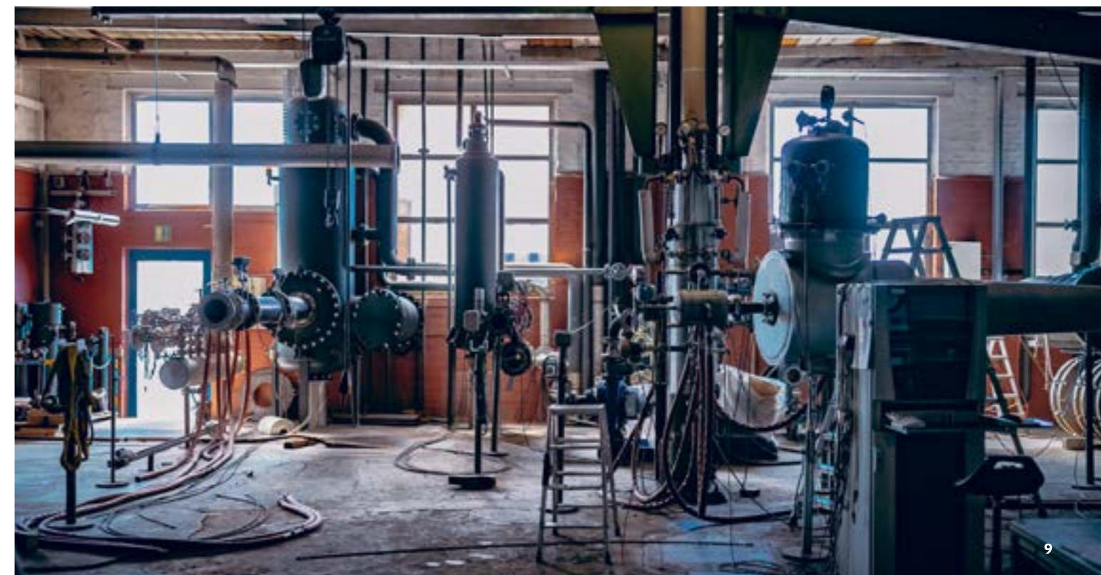
Hauseigenes Prüffeld für Leistungsproben an Dampfstrahlpumpen
