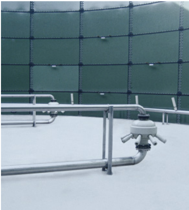
Ejektoren und Mischdüsen zur Belüftung und vollständigen Durchmischung in einem SBR-Reaktor
