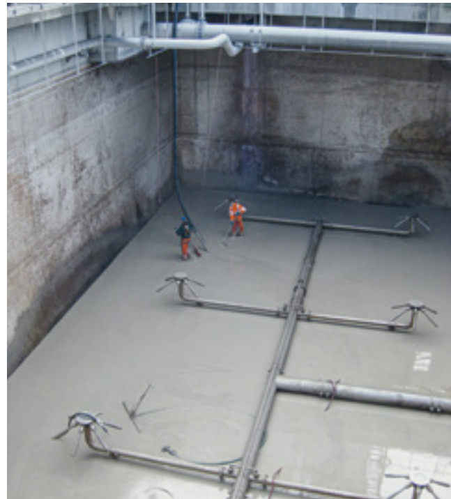
Sauerstoffeintragsystem im Belebungsbecken der Gebr. Lang GmbH Papierfabrik in Ettringen. Die sechsstrahligen Ejektoren werden mit gasförmigem Sauerstoff aus einer stationären Tankanlage versorgt.
