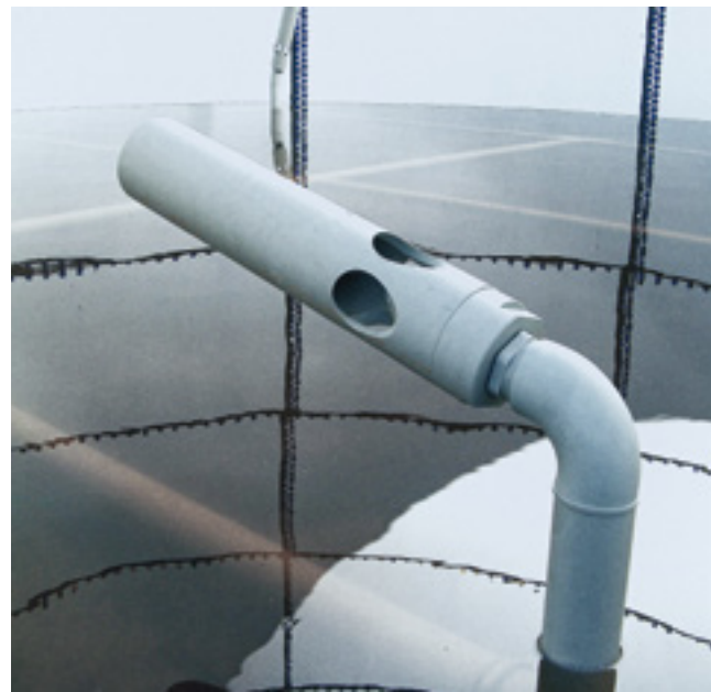
Mischdüse in einer Denitrifikation
